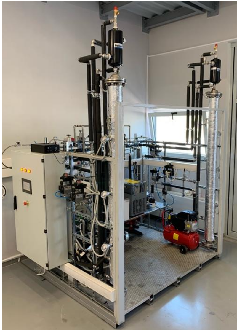
Εικόνα 1. Πιλοτική μονάδα δέσμευσης CO 2
